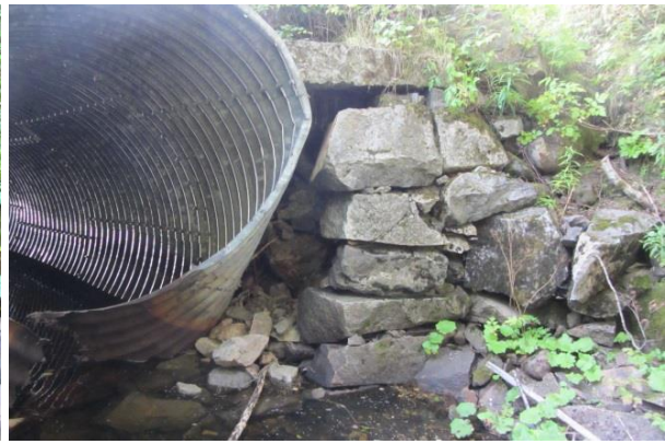
Figur 120. Demolerad uppströmssida av höger vägtrumma samt skador på fyllnadsmassor bakom kilstenstäckning.
