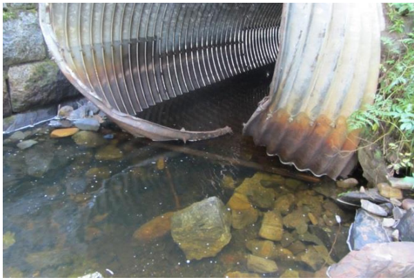
Figur 119. Demolerad uppströmssida av vänster vägtrumma.
